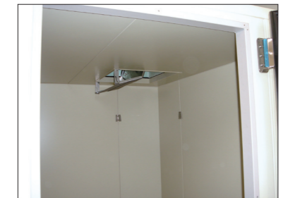
冷蔵・冷凍ユニット 庫内吹出口
